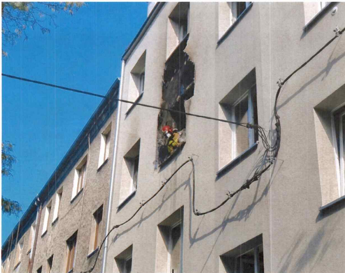
Fotografia 5 Elewacja budynku po pożarze mieszkania 04.05.2024 r.
